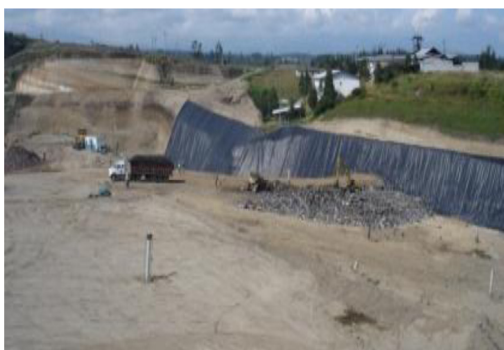
Foto 1 Cubeto en operación en el relleno sanitario
