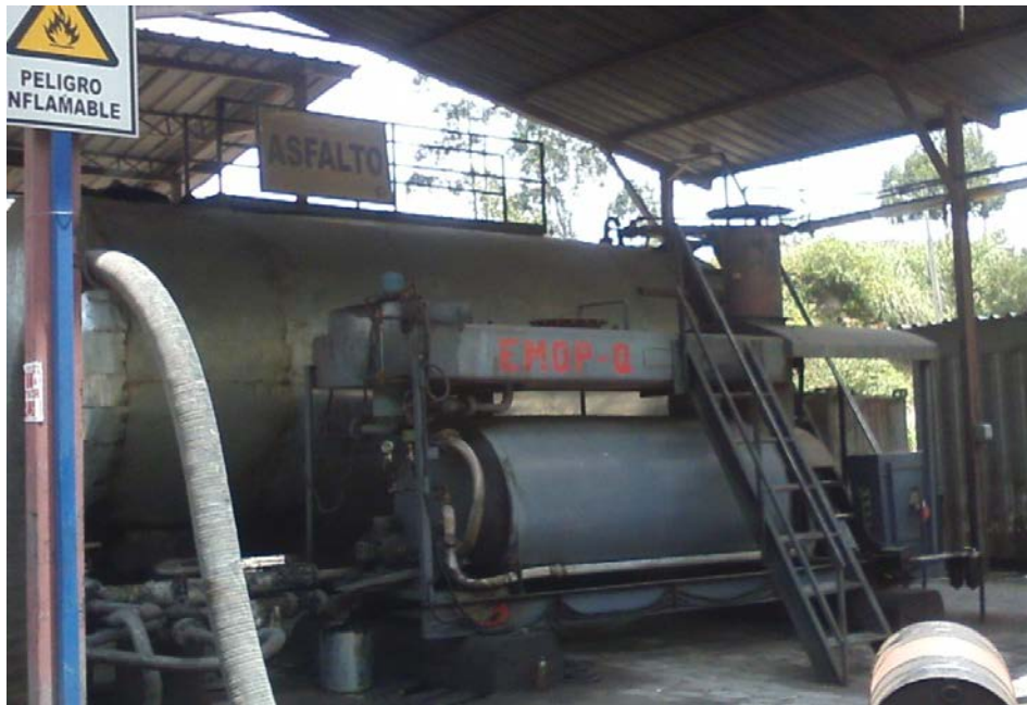
Fotografía No.2.8: Tanque de almacenamiento de Asfalto AC20.
