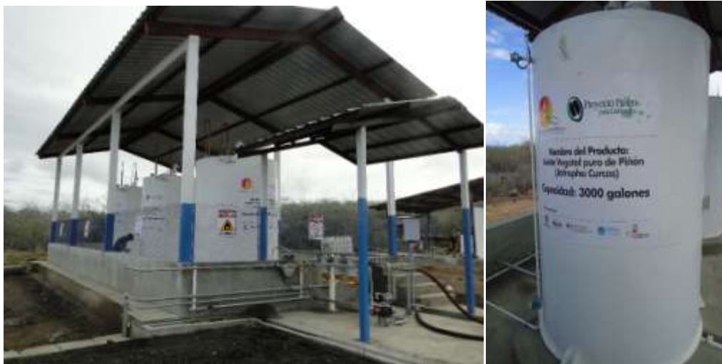
IMÁGEN 7 TANQUE DE ACEITE VEGETAL CON CAPACIDAD DE 3000 GALONES C/U
