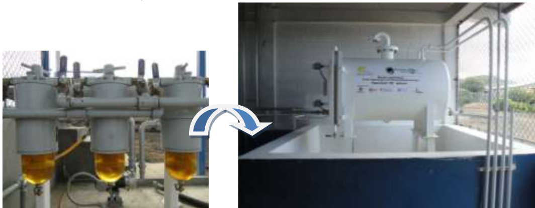
IMAGEN 8 FILTRADO A TANQUE DIARIO DE AVP CON CAPACIDAD DE 100 GALONES
