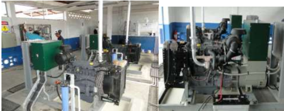
IMAGEN 9 DOS GENERADORES TÉRMICOS DE 69 KW C/U
