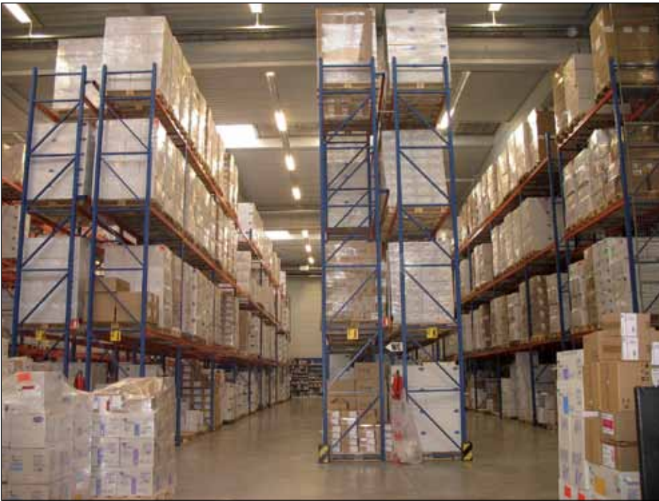
Bajo consumo de corriente en el almacén debido al control automático de la iluminación
