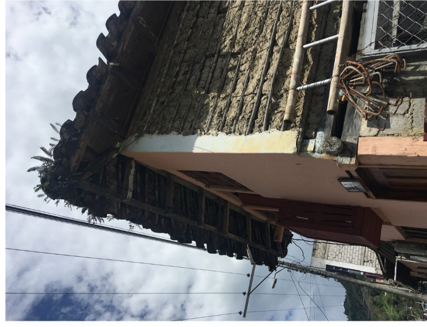
Figura 64: Viviendas autoconstruidas de Bahareque expuesto por el tiempo en mal estado. Elaboración: (Armendáriz & Cisneros,2018).
