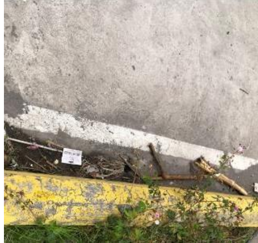
Acumulación de material granular y de basura en los laterales
