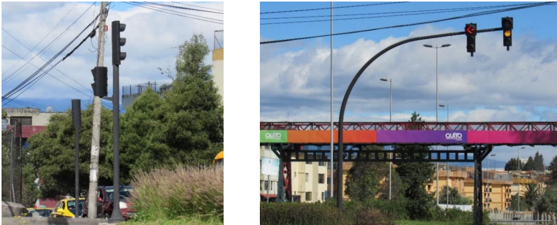
Foto N° 3-42: (Izquierda) Semáforo sujeto sobre poste. (Derecha) Semáforo sobre báculo
