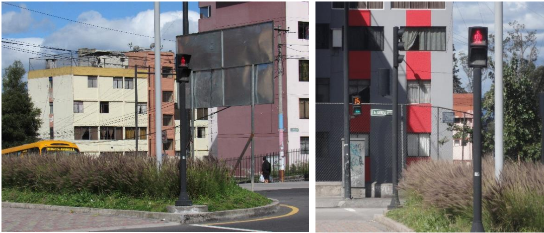
Foto N° 3-43: (Izquierda) Semáforo sujeto sobre poste. (Derecha) Semáforo sobre báculo
