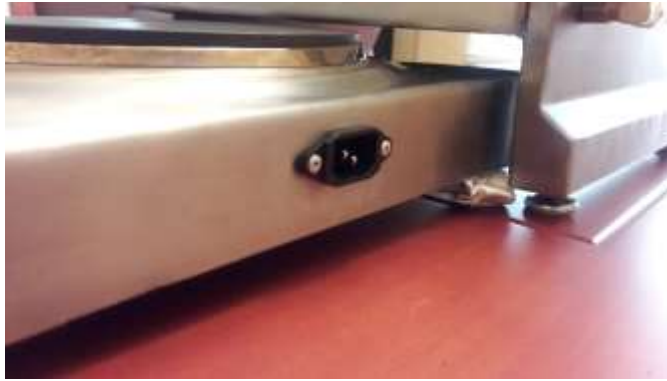
Imagen 48: Adaptación de la salida eléctrica en la cocina. Elaboración: Andrés Mejía.
