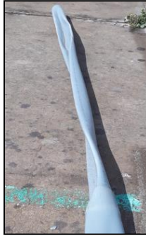
Imagen 2. Aplastamiento de tuberías.
