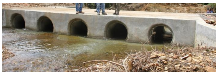
Figura 25. Alcantarilla tipo span (GAD Provincial de Imbabura, 2016)
