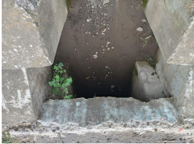
Figura 23. Alcantarilla tipo cajón Fuente: (Elaboración Propia)
