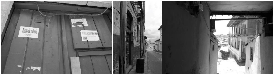
Imagen 7, 8 y 9: Edificaciones de vivienda deterioradas en SS
