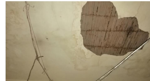
3 Desplome de recubrimiento de yeso de tumbado enchaleado de carrizo.
