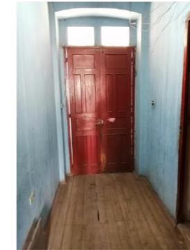
2 Deformación de madera en piso debido a descuido.
