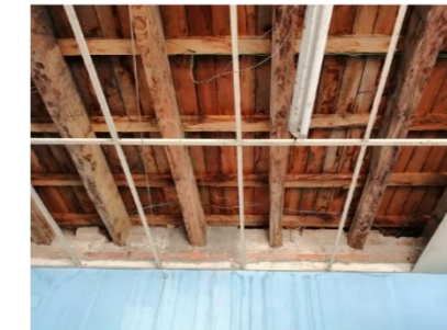
5 Deterioro de madera en cubierta debido a humedad.
