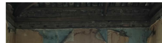
7 Desprendimiento de tapices y pintura de mampostería de adobe debido a humedad y falta de cuidado.
