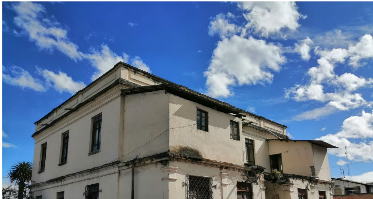
Figura 119 Patologías en fachadas bien inmueble.
