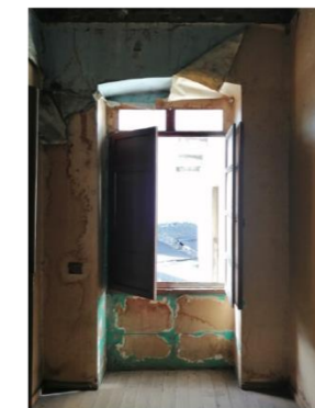
4 Desprendimiento de pintura y tapiz en mampostería.
