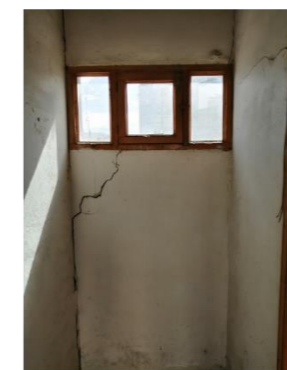
5 Agrietamiento mampostería ladrillo.
