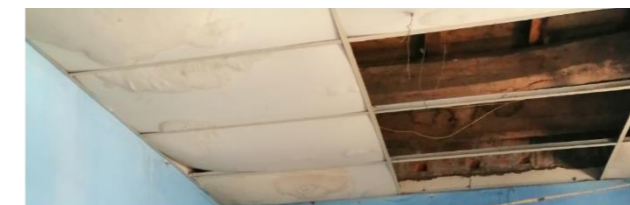
6 Desprendimiento de cielo raso.
