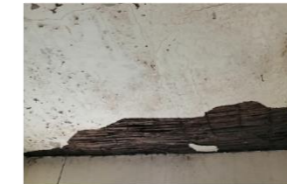
1 Desplome de recubrimiento de yeso de tumbado enchacleado de carrizo.
