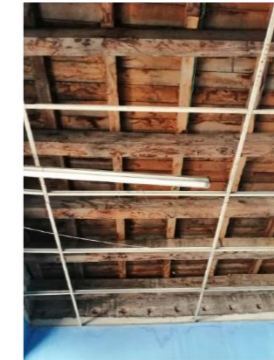
1 Desprendimiento de cielo raso debido a falta de mantenimiento.
