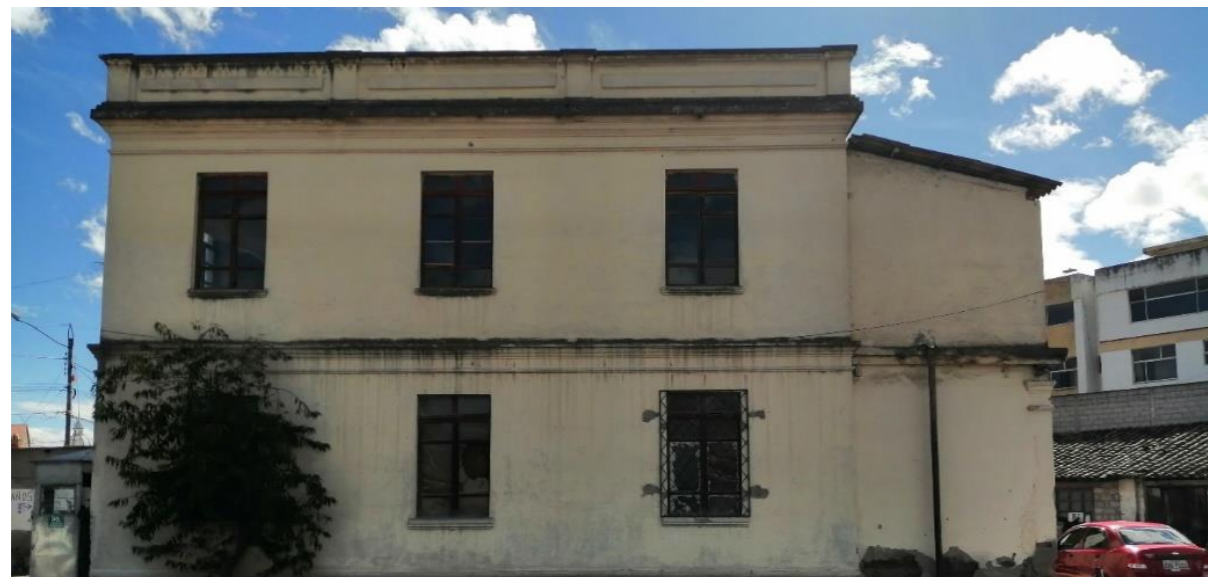
Figura 118 Fachadas donde se evidencias patologías.
