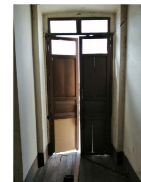
6 Pisos y puerta de madera con orificios debido a descuido.
