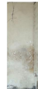
4 Humedad en mampostería.
