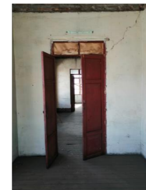
3 Agrietamiento recubrimiento mampostería adobe.
