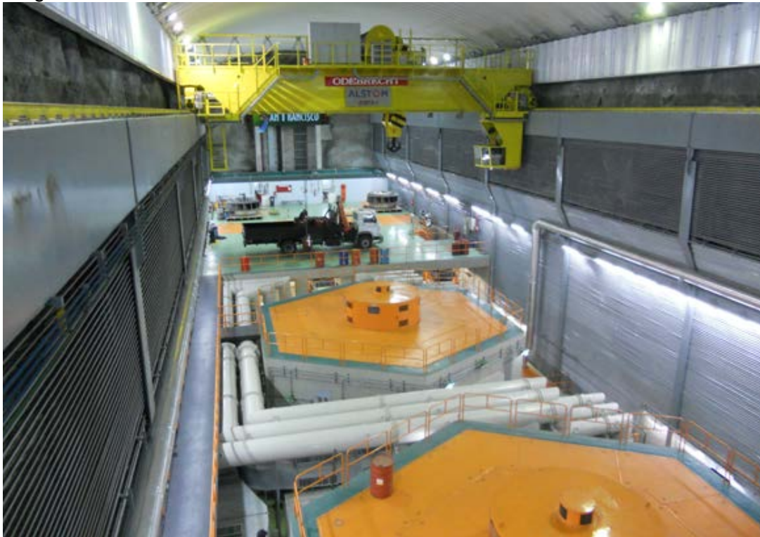
Descripción: Casa de Máquinas central San Francisco Fotografía: David Burbano Montalvo
