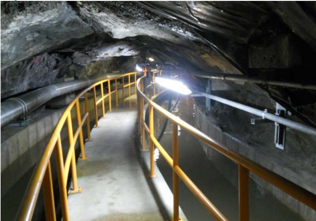
Descripción: Nuevo Sistema de Agua de Enfriamiento 2 Fotografía: David Burbano Montalvo
