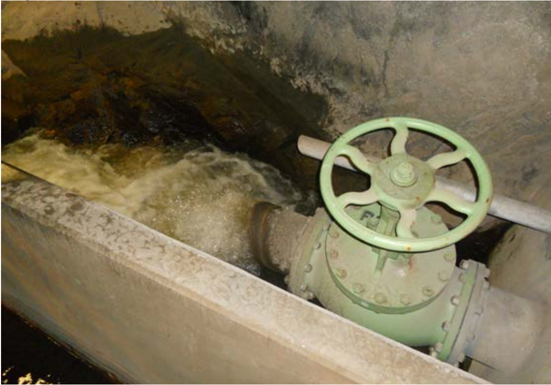
Descripción: Nuevo Sistema de Agua de Enfriamiento 1 Fotografía: David Burbano Montalvo
