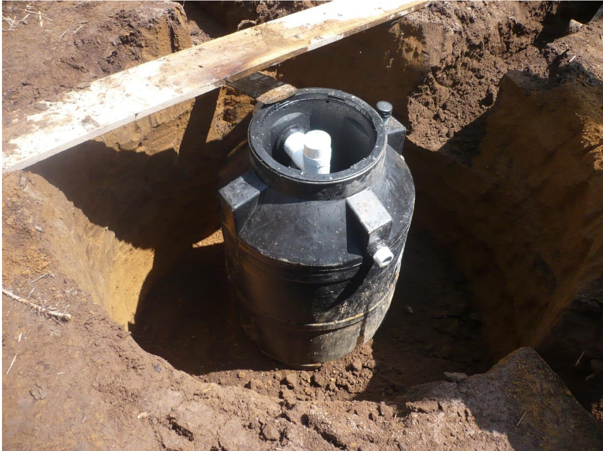
Figura No. 83. Instalaciones hidro-sanitarias implementadas en las viviendas de carácter emergente. San Pedro de Suma
