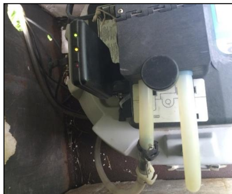
Fotografía 8. Conexión de manguera de succión al equipo de aforo
