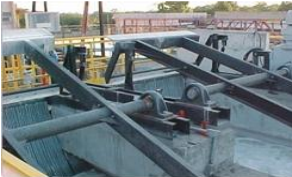
Anexo N° 2. Criba de limpieza mecánica.
