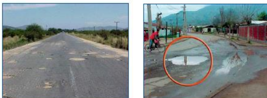
Ilustración 3-9 Vías Rurales con presencia de baches y acumulación de agua Fuente: Dourthé Castrillón & Salamanca Candia, 2003
