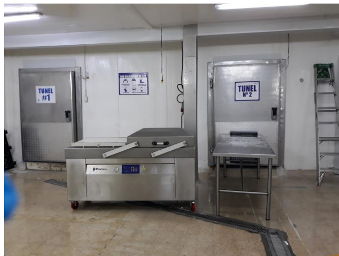
Figura 18.- Túneles de congelación (Propia del autor)
