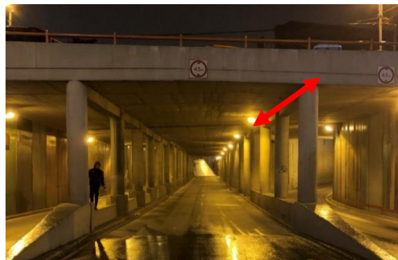
Figure 33 Falta de luminarias en la Boca de Paso inferior Av. Patria y 12 de octubre - Entrada Sur
