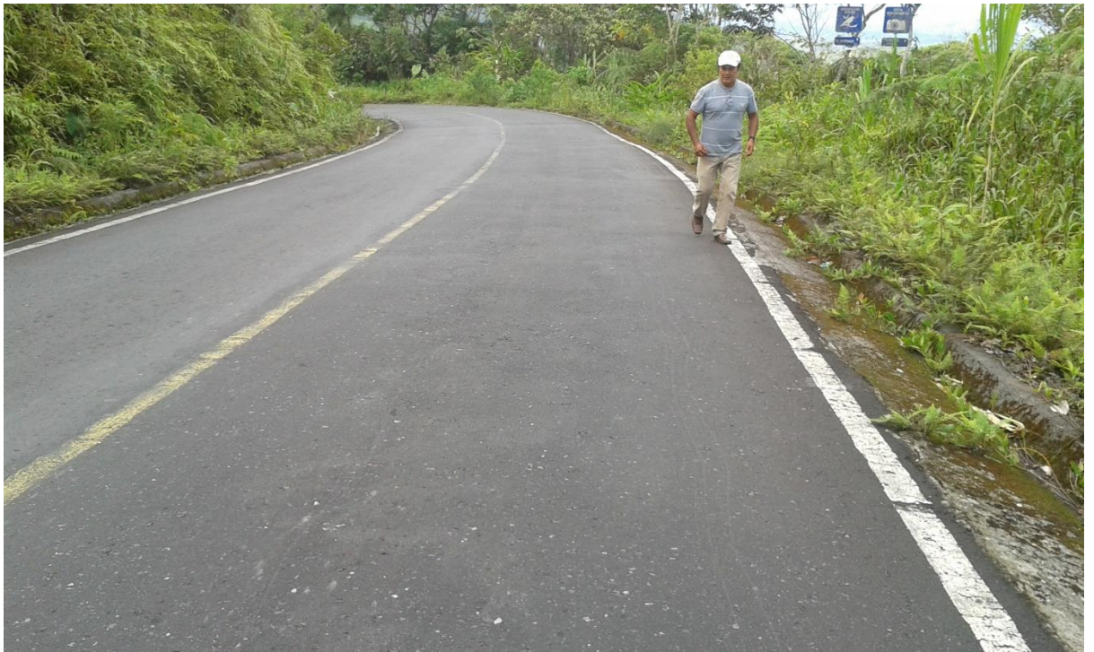
Fotografía N° 8: Falla N° 05- Corrugación
