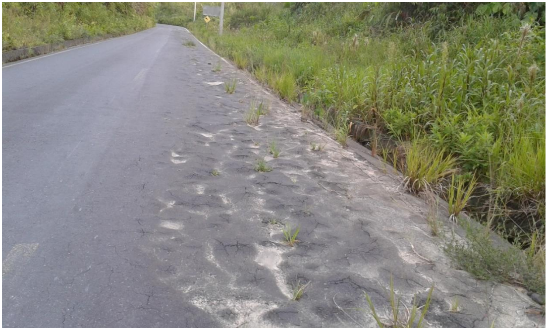
Fotografía N° 9: Falla N° 06-Depresion
