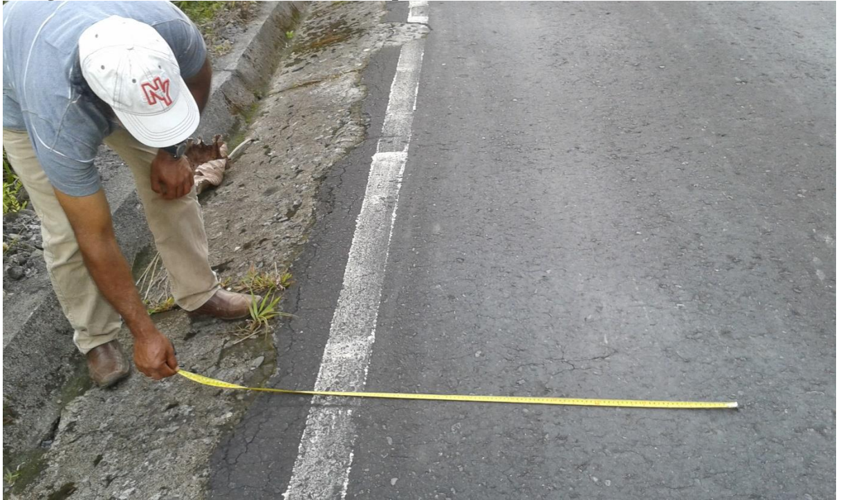
Fotografía N° 4: Falla n° 3- Fisuras en bloque
