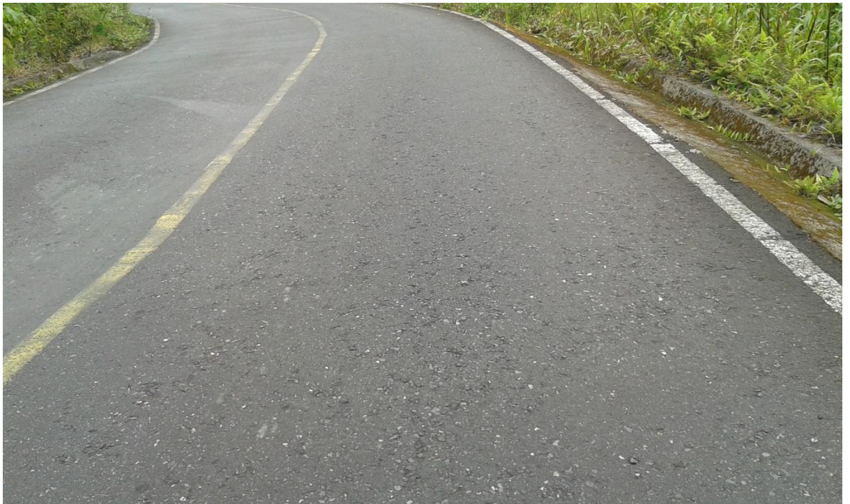
Fotografía N° 19: Falla N° 19 - Intemperismo / Desmoronamiento
