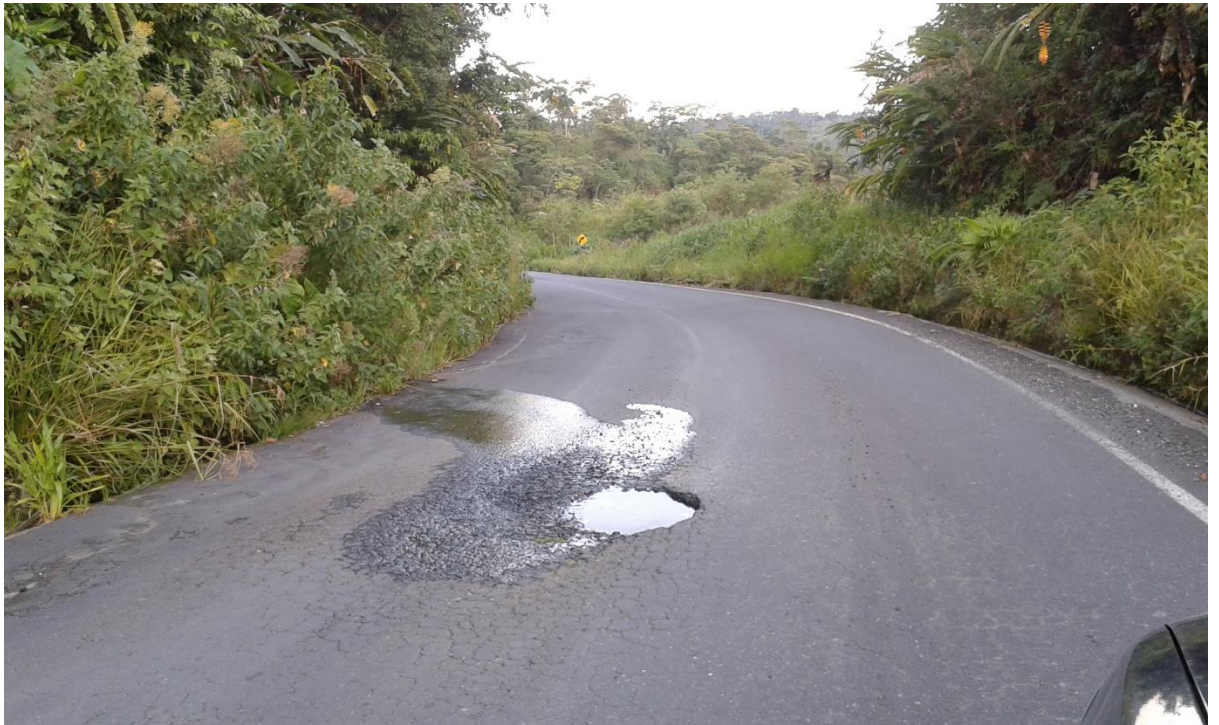
Fotografía N° 15: Falla N° 13 - Baches
