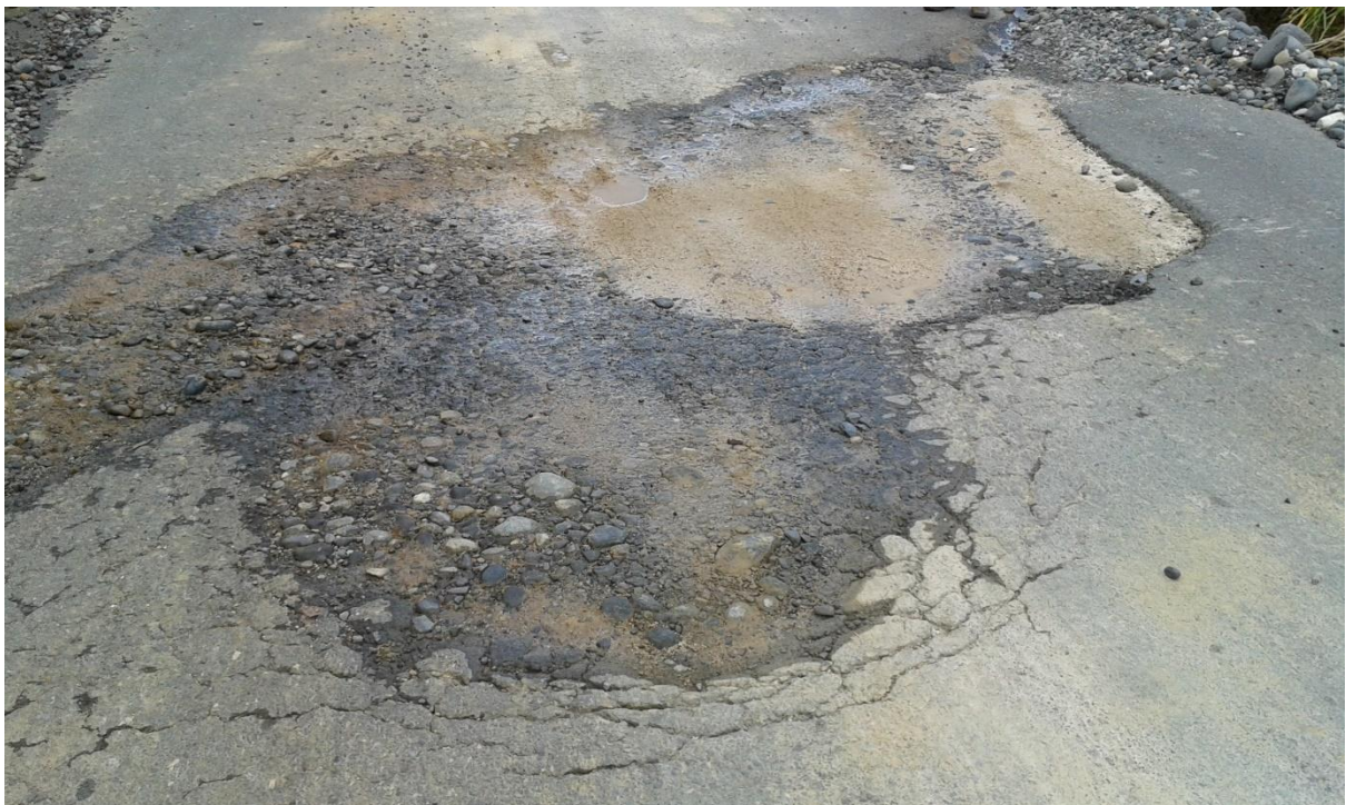
Fotografía N° 16: Falla N° 13 - Baches
