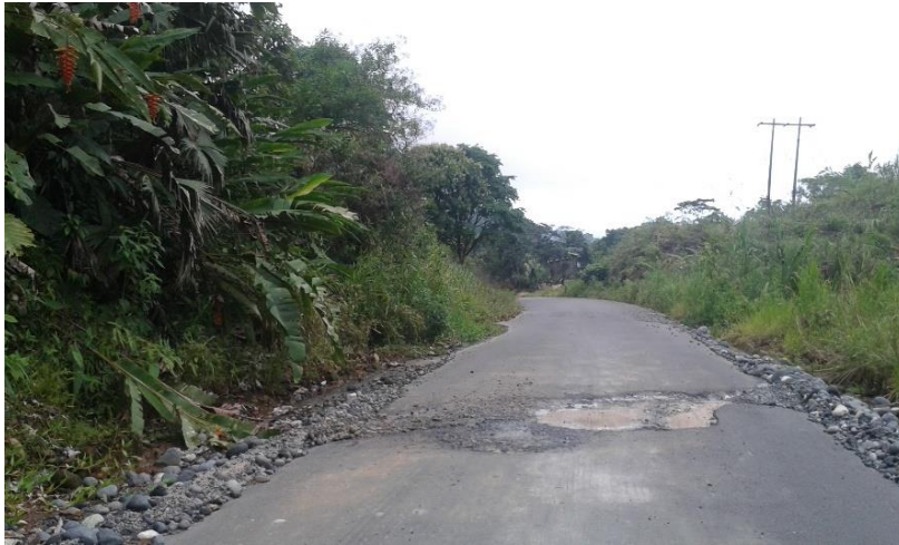
Fotografía N° 26: Derrumbes en la vía
