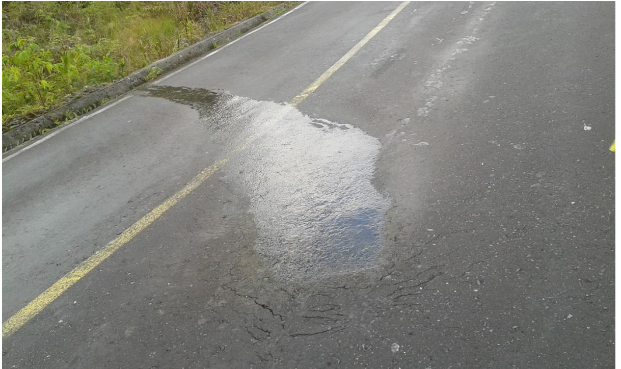
Fotografía N° 10: Falla N° 07- Fisuras de borde
