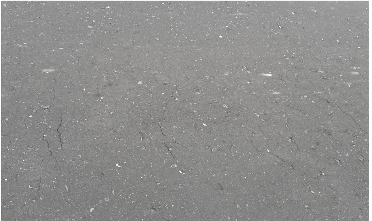
Fotografía N° 18: Falla N° 17 - Fisuramiento de resbalamiento
