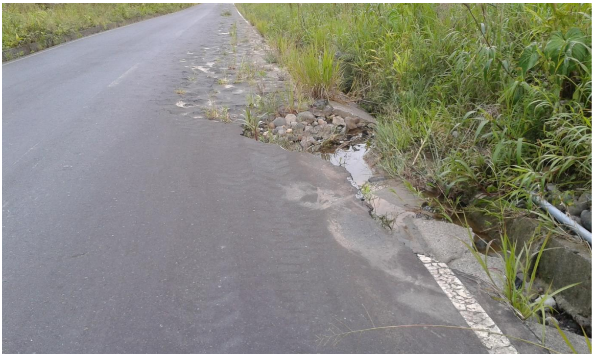
Fotografía N° 11: Falla N° 07- Fisuras de borde
