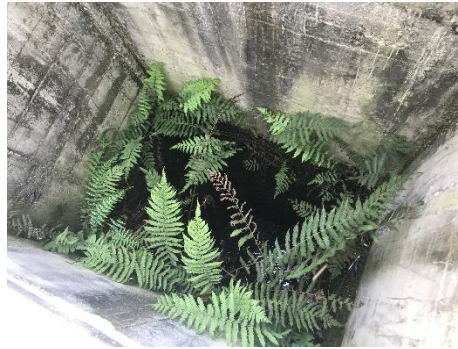
Figura 24. Fotografía caja de revisión Panamericana Norte. Fuente: autoría propia
