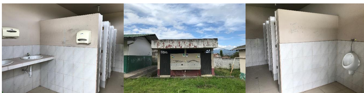
Figura 29. Baños sin uso y en buen estado en el bloque 4. Fuente: autoría propia
