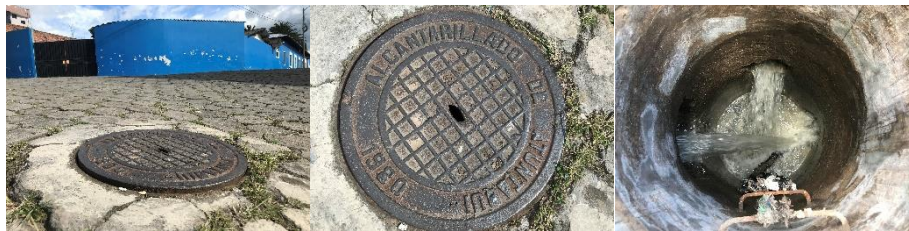
Figura 22. Fotografías caja de revisión en la calle Abdón Calderón y Rocafuerte
