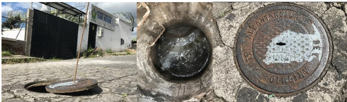
Figura 25. Fotografías caja de revisión calle Oswaldo Pérez. Fuente: autoría propia.
