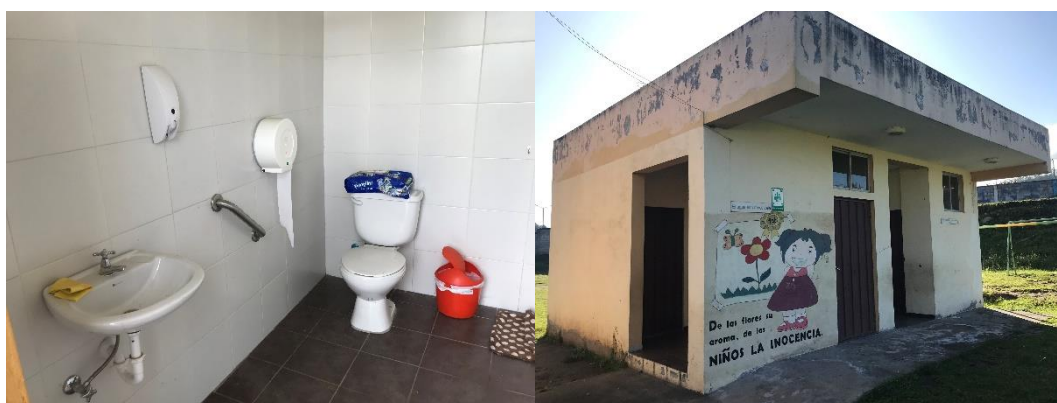
Figura 28. Baño para personas con discapacidad en el bloque 2. Fuente: autoría propia
