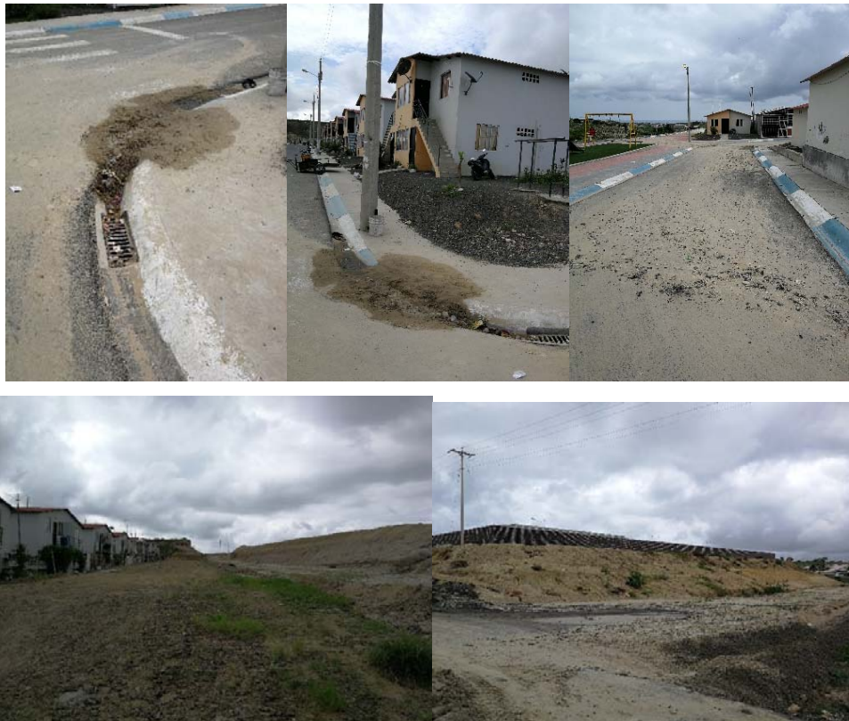
Imagen 41. Red de recolección de aguas lluvias
