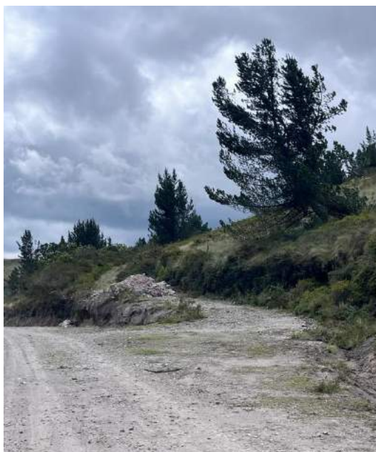
Ilustración 60. Vía con tramo cortado
