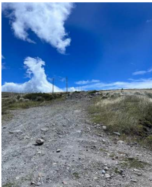
Ilustración 61. Vía con tramo cortado
