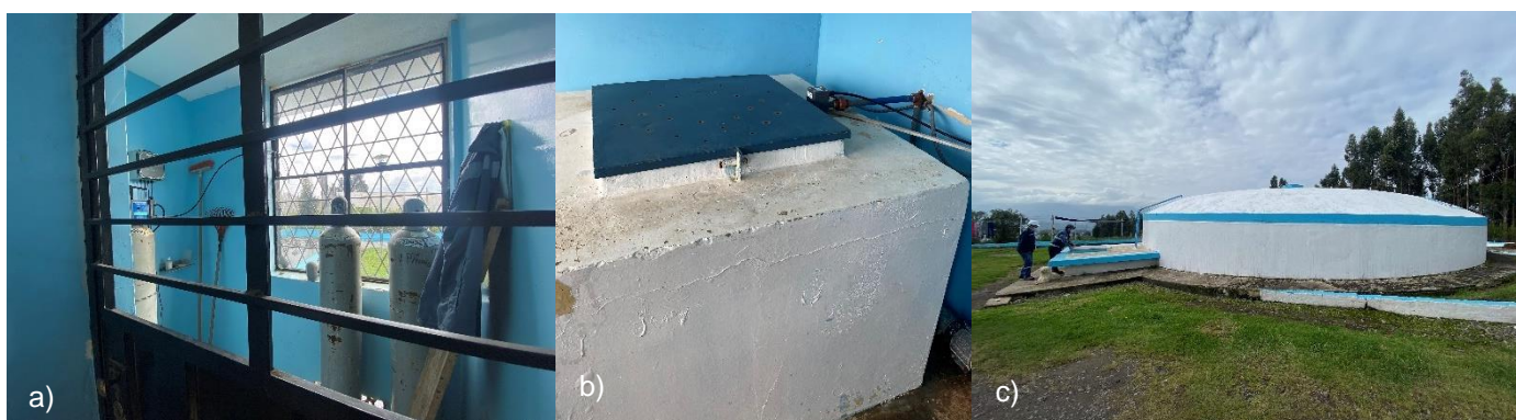
Ilustración 9. Planta Central EMASA PM, a) Sistema de cloro gas, b) tanque de solución de cloro, c) Tanque de almacenamiento 650 m 3
