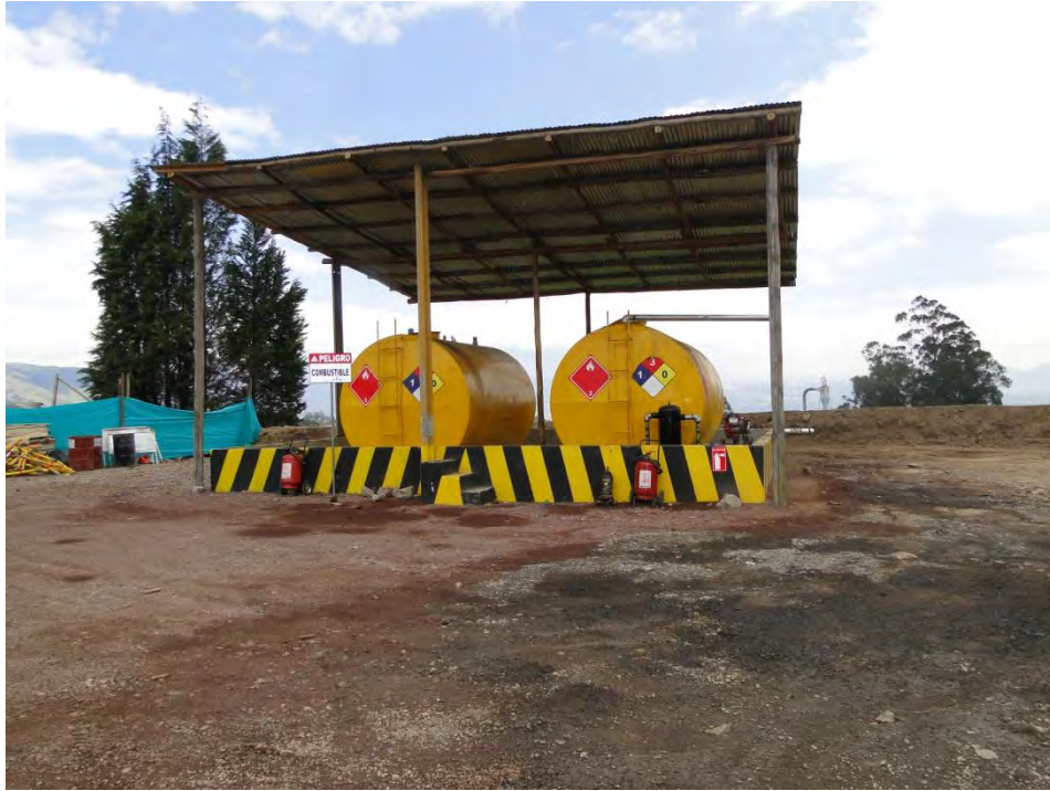
Ilustración 3-15: Depósitos de combustible en un campamento
