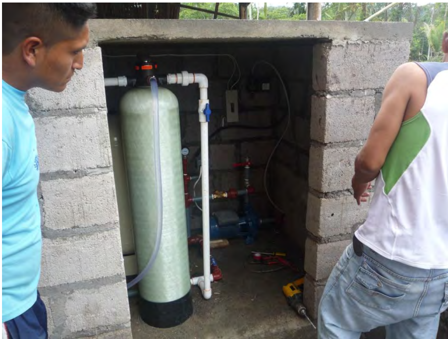
Ilustración 3-14: Sistema de filtrado y clorinación de agua en el campamento
