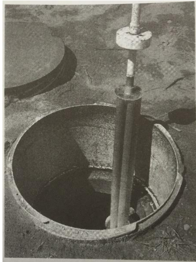
Imagen 28 Elemento filtrante removido para limpieza
