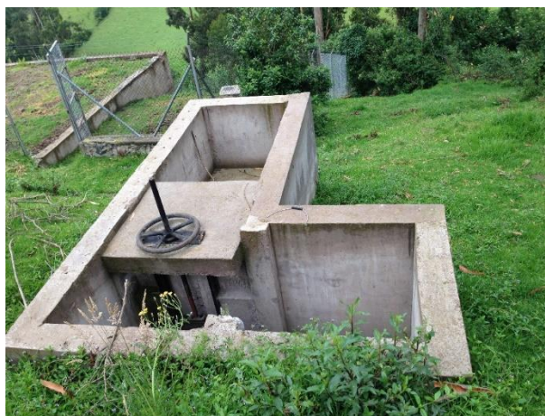
Foto 1 Separador de caudales, compuerta de ingreso y cribado
