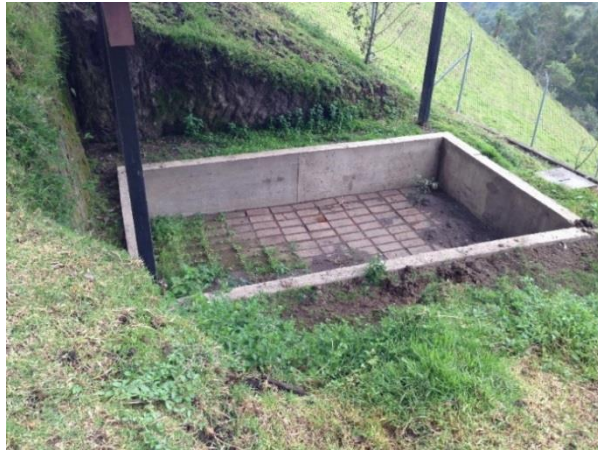
Foto 46 Fondo del lecho de secado de lodos
