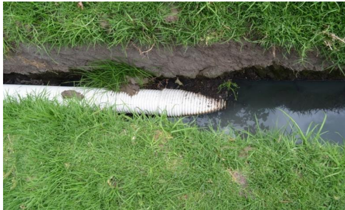
Foto 35 Tubería del Cuarto pozo
