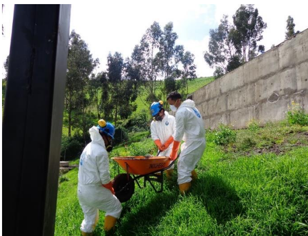
Fuente: EPMAPS – Departamento de Tratamiento de Aguas Residuales
