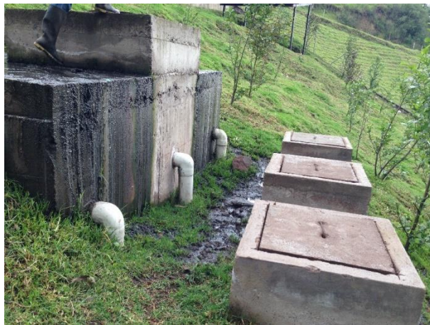
Foto 33 Salida del FAFA hacia los pozos de infiltración
