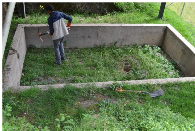
Foto 47 Fondo del lecho de secado de lodos
