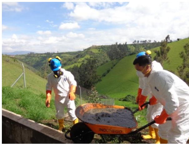
Foto 48 Transporte manual de los lodos del cribado hacia el lecho de secado
