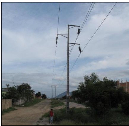
Foto 11 Sublínea de transmisión eléctrica
