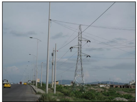
Foto 12 Línea de transmisión eléctrica
