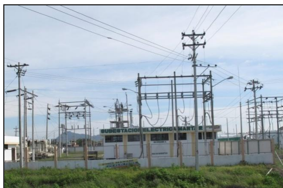
Foto 10 Subestación Eléctrica Manta II
