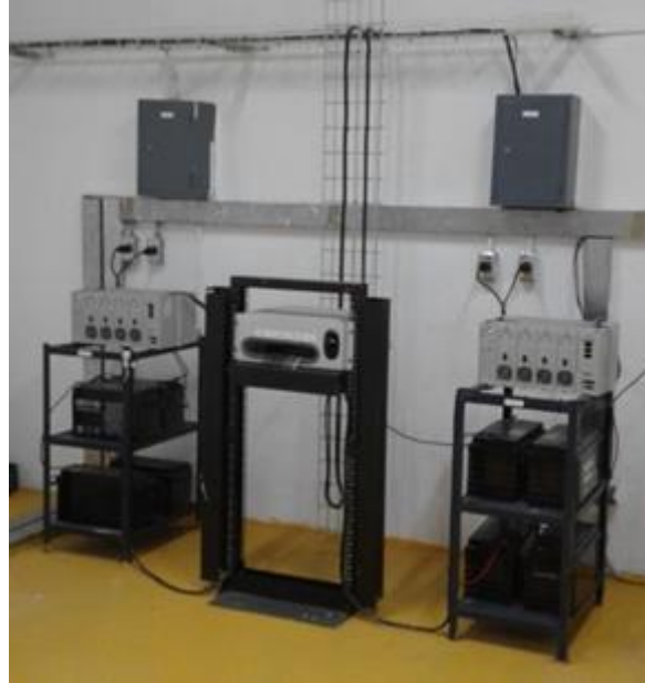
Figura 2-11 Ubicación de equipos
