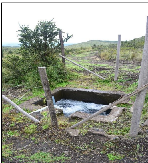
Fotografía 3: Tanque de carga - almacenamiento del sistema de riego San Ramón
