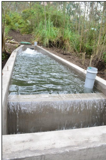
Fotografía 4: Cámara rompe presión del sistema de riego de San Ramón
