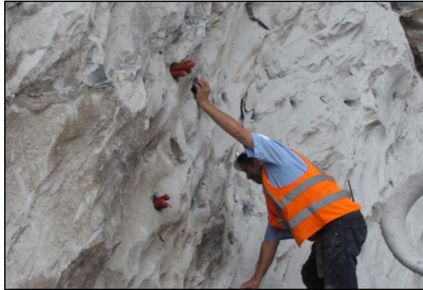
Foto 1.21. Colocación manual de resina en la perforación donde será colocado el perno de anclaje.
