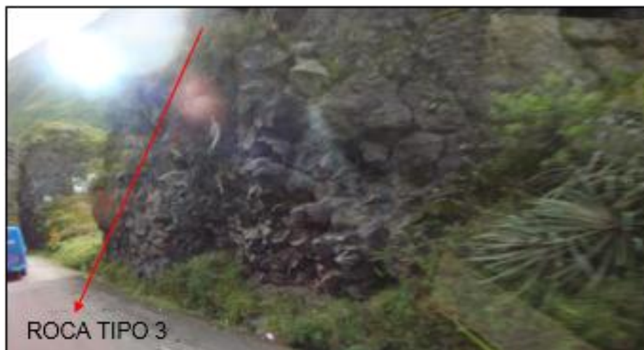
Foto 1.14. Corte carretera ingreso a Baños, puente las Juntas.
