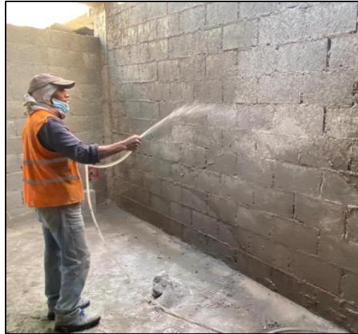
Ilustración 32 Humedecimiento de pared
