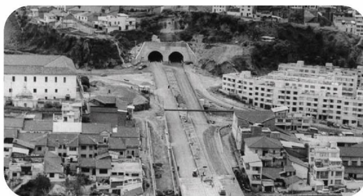
Construcción de los túneles en San Diego, San Roque y El Tejar, en Quito
