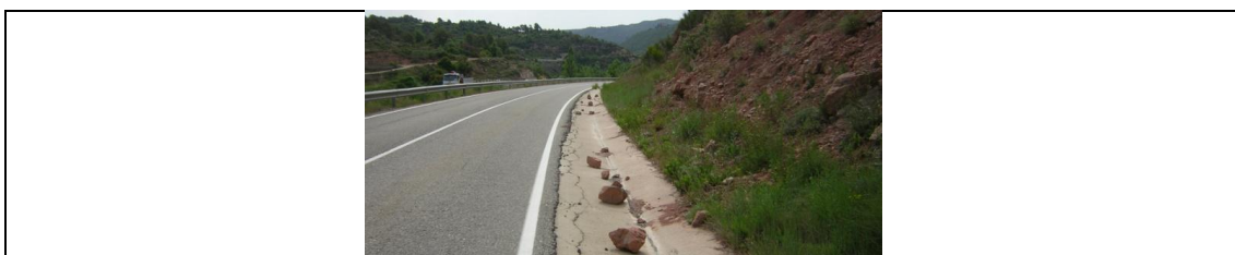
Figura 1.16.3.3 Deslizamiento de materiales libres en una vía, tomado de [geotecnia-y-geologia.blogspot.com]
