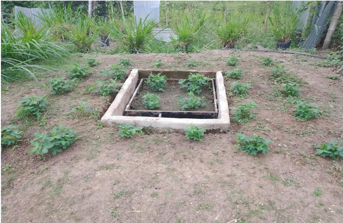
Figura 11: Mantenimiento y limpieza
