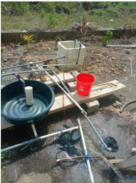
Fotografía 4: Prueba con el agua circulando en el sistema.
