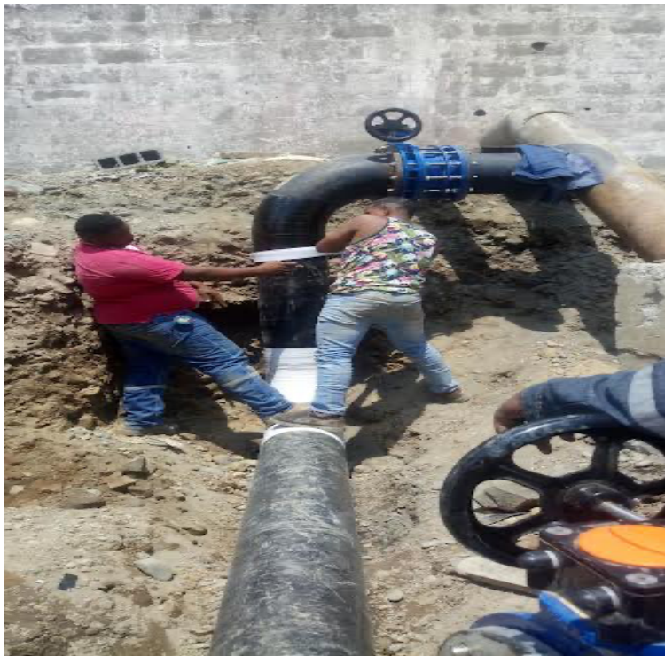
Figura 5 Trabajadores sin uniforme, credencial ni EPP
