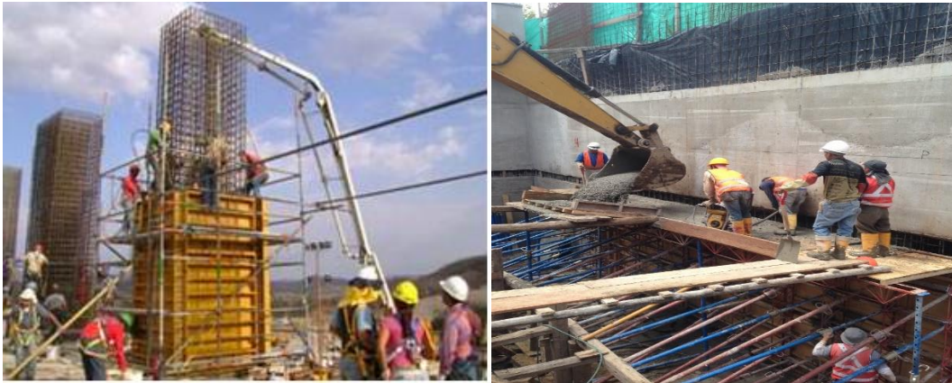
[Imagen de líneas de vida verticales, ausencia de líneas verticales]. Recuperado de Edificio Tiziano
