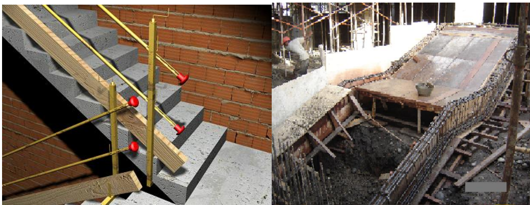
[Imagen de pasamanos provisionales en escaleras].
