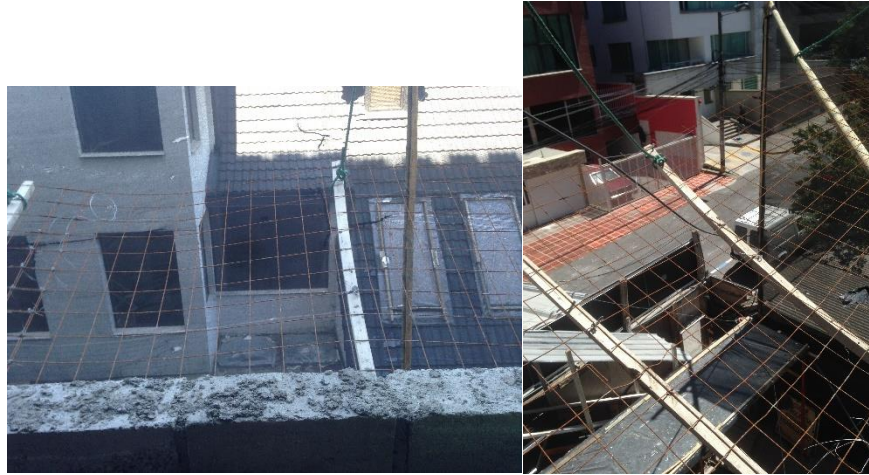
[Imágenes de redes de seguridad]. Recuperado de Edificio Estrella IX
