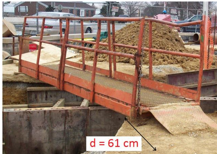
[Imagen de pasarelas]. Recuperado de http://www.ehss.vt.edu/images/EXC_cross_over.jpg
