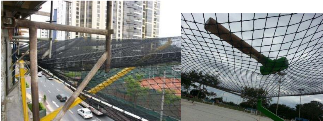
[Imagen de red de protección]. http://www.constructivo.com/actualidad/redes2.jpg
