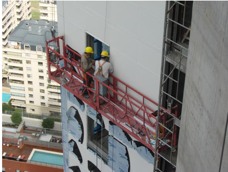
[Imagen de falta de limpieza sobre andamios colgantes]. http://i.ytimg.com/vi/ZzPhyujh4r0/hqdefault.jpg
