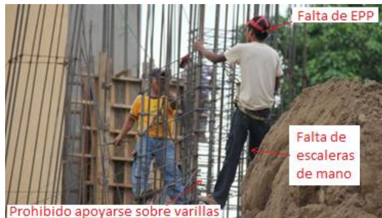
[Imágenes de armado de columnas, falta de escaleras de mano]. Recuperado de http://portal.andina.com.pe/EDPfotografia2/Thumbnail/2010/09/29/000137198W.jpg
