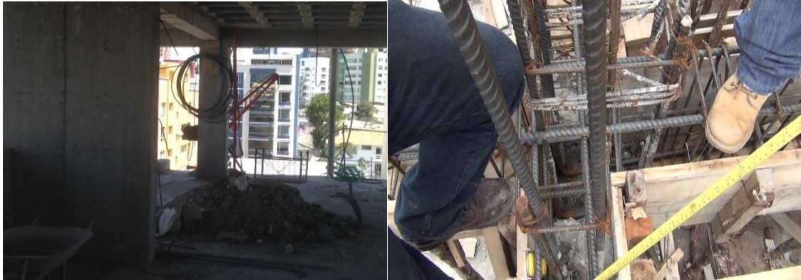
[Imagen de escombros y obstáculos]. Recuperado de Edificio Estrella IX
