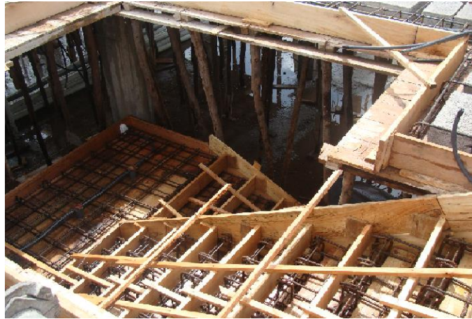
[Imagen de pasamanos provisionales en escaleras]. Recuperado de Edificio Estrella IX
