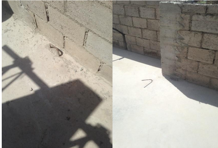
[Imágenes de ganchos metálicos de seguridad]. Recuperado de Edificio Estrella IX
