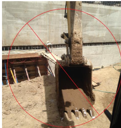
[Imagen de prohibición de ingreso a personal en excavaciones mecánicas. Recuperado de Edificio Tiziano
