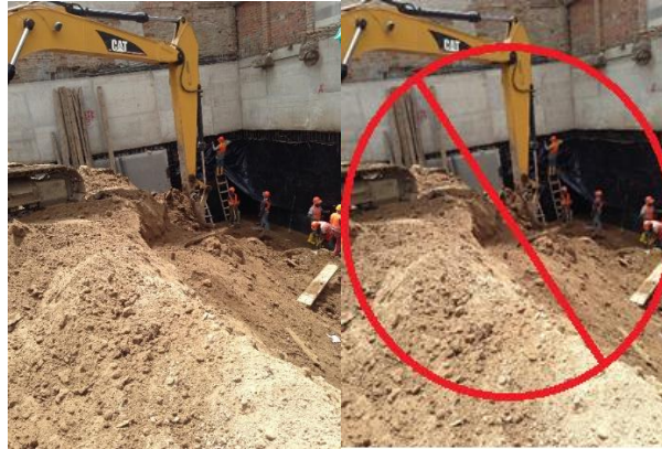
[Imagen de excavación, obstáculos, suelo desuniforme]. Recuperado de Edificio Tiziano
