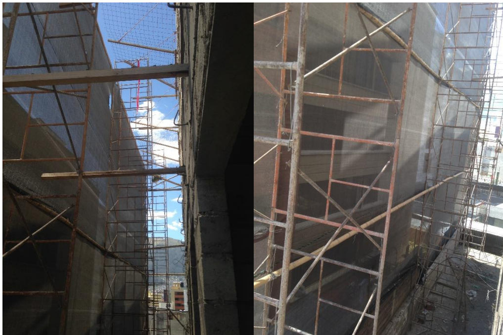
[Imagen de andamio fijo sobre estructura]. Recuperado de Edificio Estrella IX
