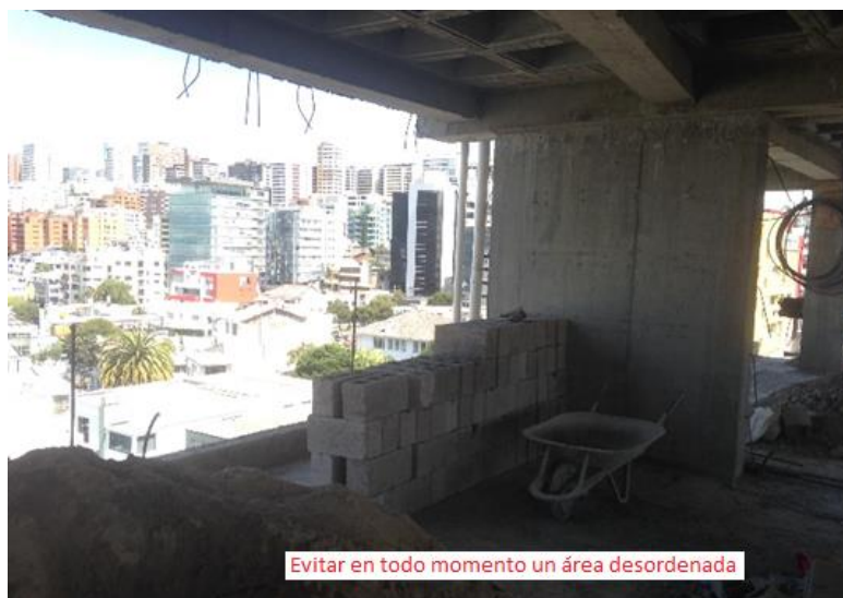
[Imagen de desorden en área de acabados]. Recuperado de Edificio Estrella IX
