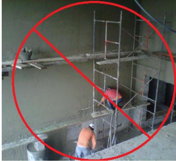
[Imagen de ausencia de líneas de vida verticales, arnés de seguridad]. Recuperado de http://4.bp.blogspot.com/_zU1uEbEORs/SRP7F-9L4ZI/AAAAAAAAAC0/YOIWbnT80nM/s320/safety_harness_02.jpg
