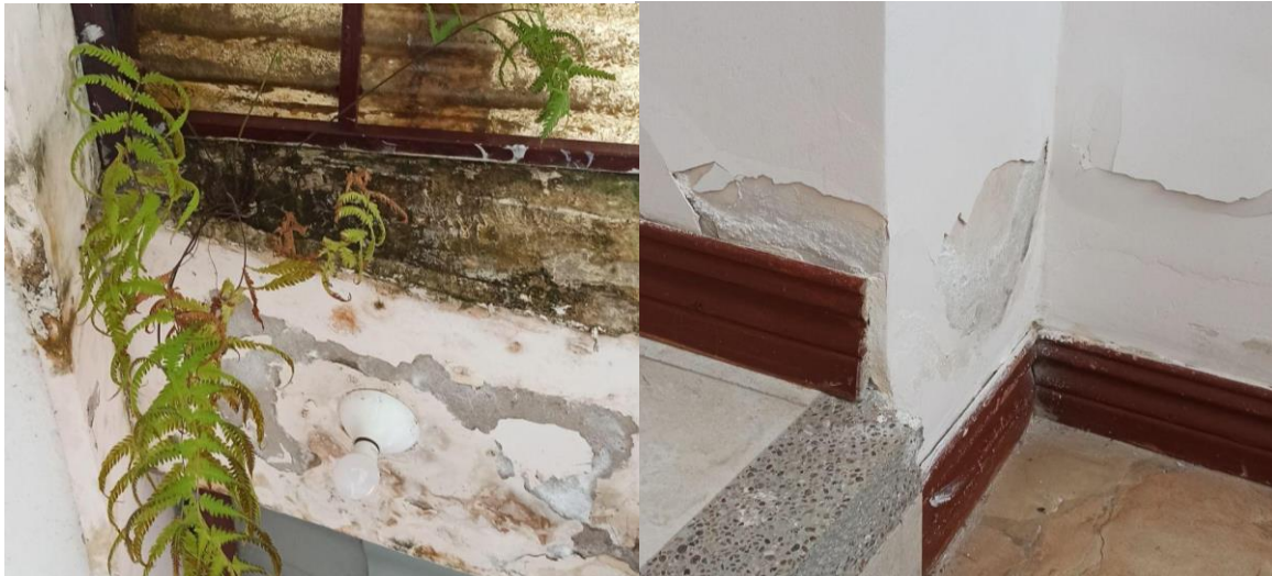
Figura 53: Crecimiento de vegetación y hongos en edificaciones.
