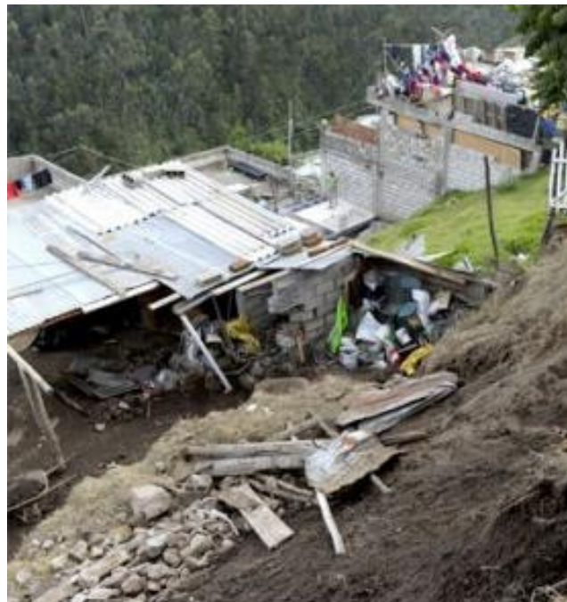
Fotografía 2: Un deslizamiento de tierra dañó una vivienda en Quito,
