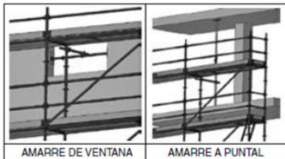
ILUSTRACIÓN 8: TIPOS DE AMARRE, VISTA DE DISTINTOS AMARRES UBICADOS EN OBRA. FUENTE: NTP 1015
