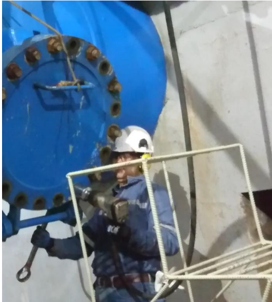
ILUSTRACIÓN 39 FOTO TOMADA EN LA CENTRAL HIDROELÉCTRICA "TOPO" MANIPULACIÓN DE HERRAMIENTA NEUMÁTICA CON UNA SOLA MANO CUANDO ESTA REQUIERE EL USO DE AMBAS PARA SU SEGURIDAD
