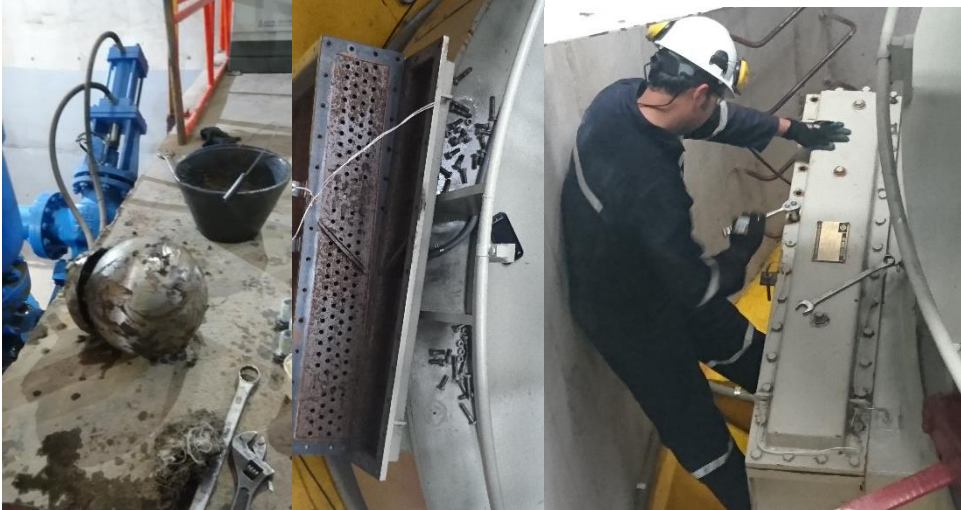
ILUSTRACIÓN 41 FOTOS TOMADAS EN LA CENTRAL HIDROELÉCTRICA TOPO, EJEMPLAS DE OBJETOS QUE PUEDEN OCASIONAR ACCIDENTES AL CAER O AL PISARLOS POR SU DISPOSICIÓN
