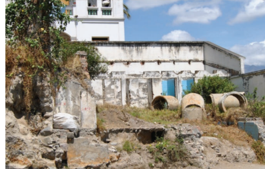
Figura 154. "Antiguo" Balneario Yanayaku, en deterioro - Otavalo Fuente: Fernanda Dávila, 2016
