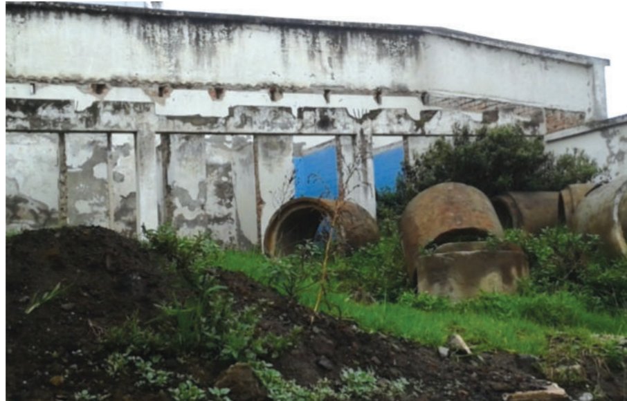
Figura 153. Escombros sobre el "Antiguo" Balneario Yanayaku - Otavalo Fuente: Fernanda Dávila, 2016
