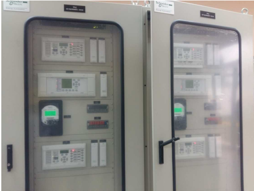
Anexo. 1 Medidor de frontera
