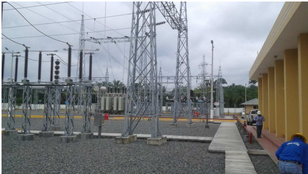
Anexo. 2 Estructura eléctrica llegada interconectado
