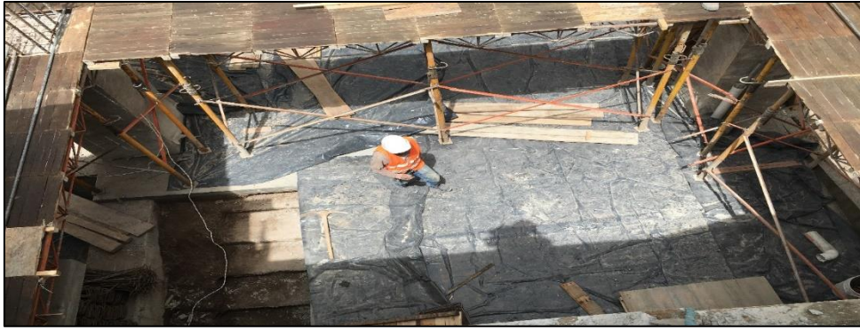
Fotografía 28: Se observa claramente como el trabajador queda cercado por el encofrado, lo que limita y dificulta su movimiento.
