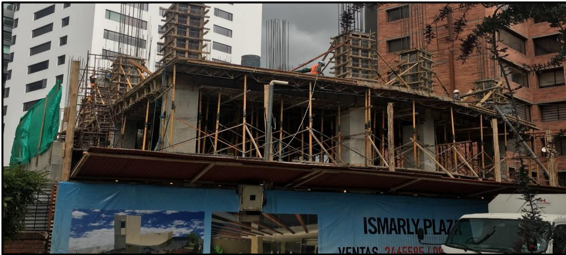
Fotografía 1: Sistema tradicional de encofrado
