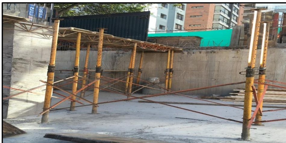
Fotografía 19: En esta imagen se puede ver como se inicia los procesos del encofrado, con la colocación de puntales y crucetas, una vez replanteados los ejes de las vigas.
