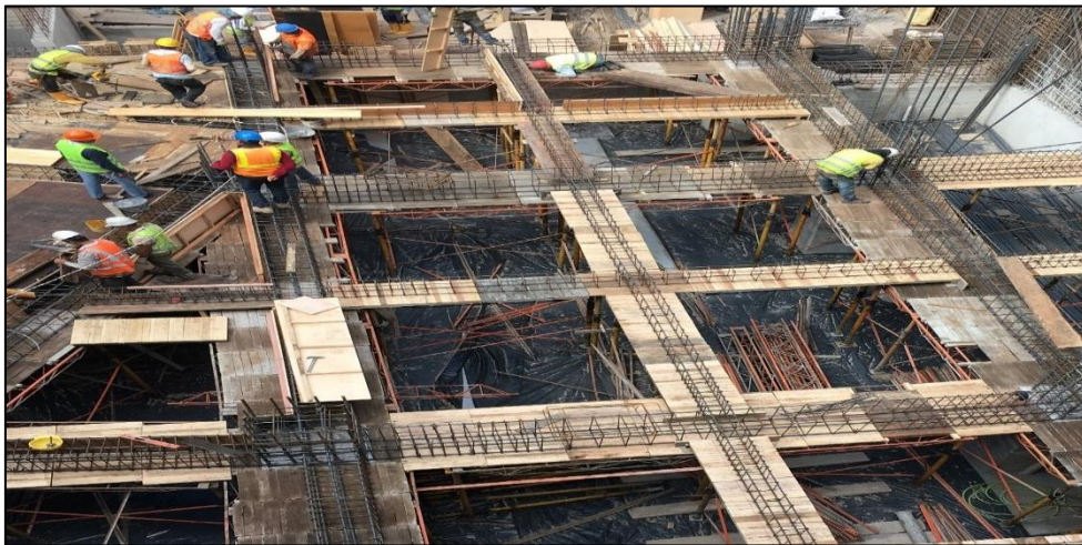
Fotografía 22: Se muestra la colocación de tableros de madera para vigas, el armado de las vigas y el inicio de la colocación de los tableros laterales.
