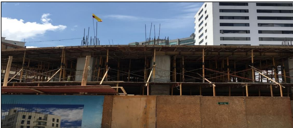
Fotografía 27: En la imagen se puede ver claramente ubicación de las crucetas y la incomodidad que representaría el acceso a la losa inferior, puesto que las crucetas se colocan en sentido longitudinal y transversal.
