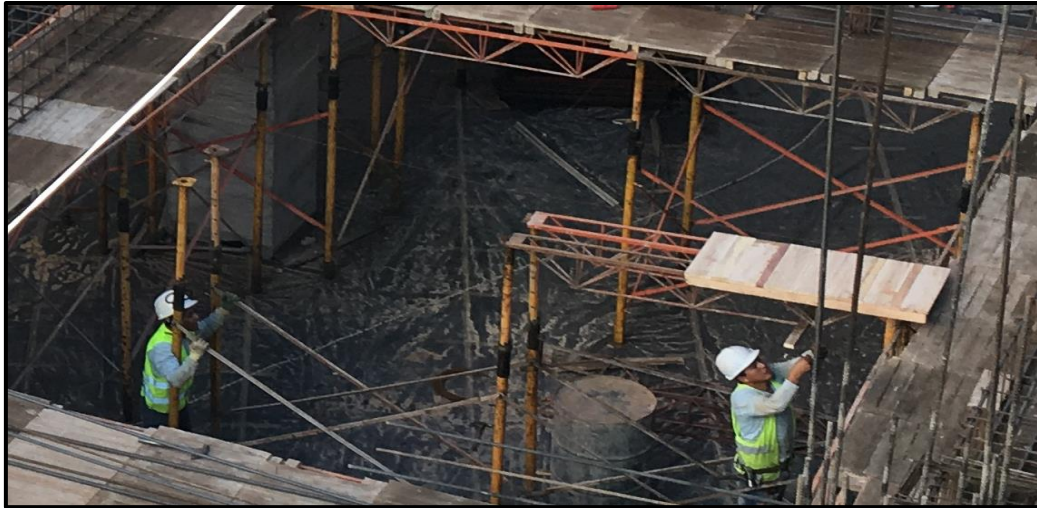
Fotografía 20: En esta fotografía se puede ver la instalación de los puntales y viguetas. El tablero colocado solo es una guía para la separación entre viguetas.
