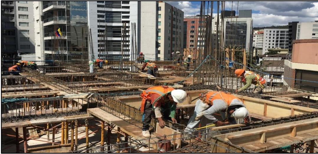
Fotografía 23: En esta fotografía se puede ver la colocación de los tableros laterales.
