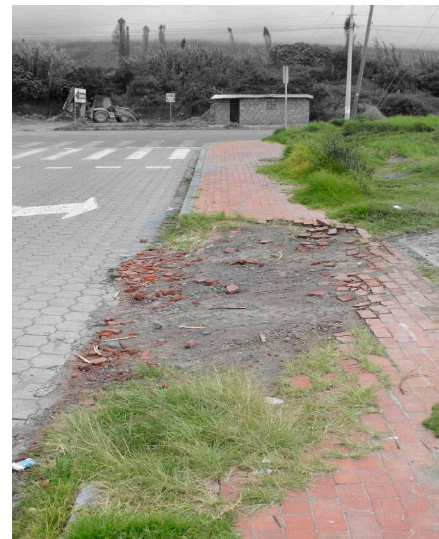
Figura 69: Acera en deterioro en el sector Los Galeanos Fuente: Elaboración propia
