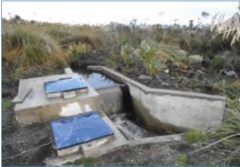
Fotografía N° 3. Repartidor Caudales “El Ovalo” – 3623 msnm
