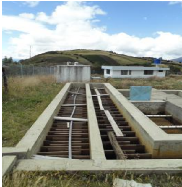
Fotografía N° 6. Floculador Hidráulico de Placas con Flujo Horizontal
