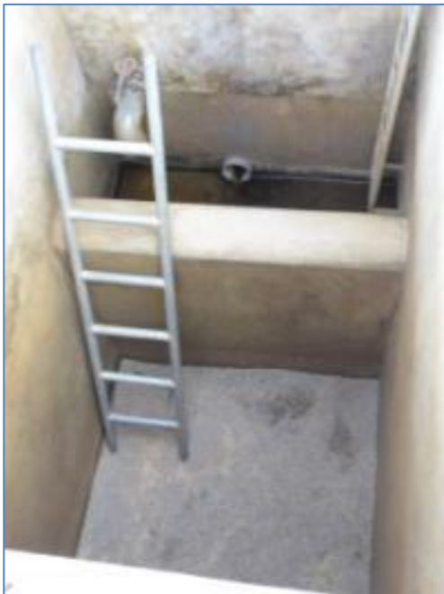
Fotografías N° 9. Unidad de Filtración
