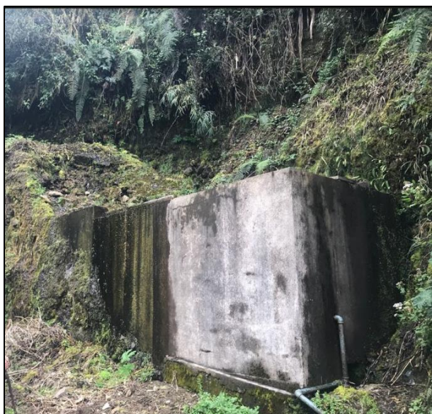
Fotografía 3. Tanque de agua principal (3.306msnm)
