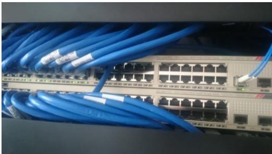
Ilustración 18, Switch de acceso en sitio
