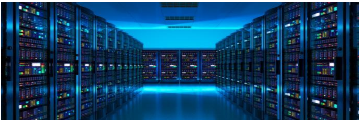
Figura 5: Sala de servidores Fuente: (Velasco,2019)
