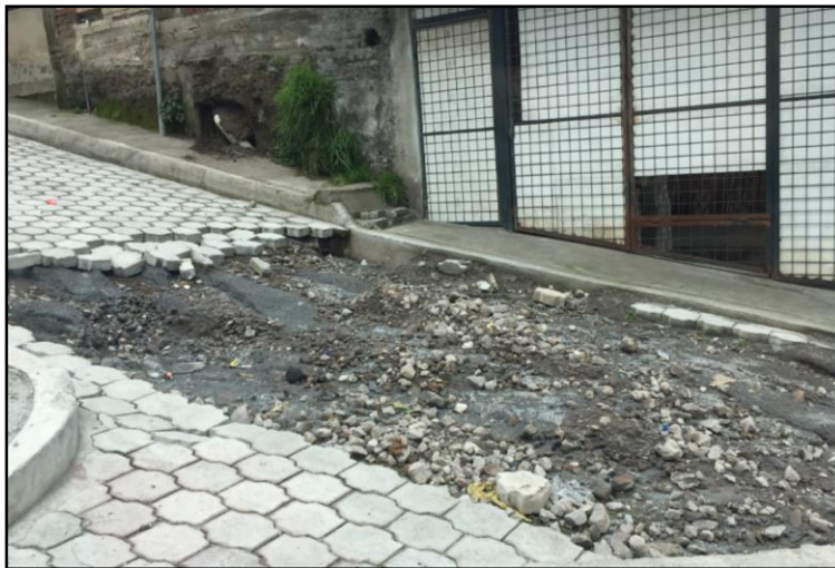
Foto No.31 Daños en adoquinado por época lluviosa
