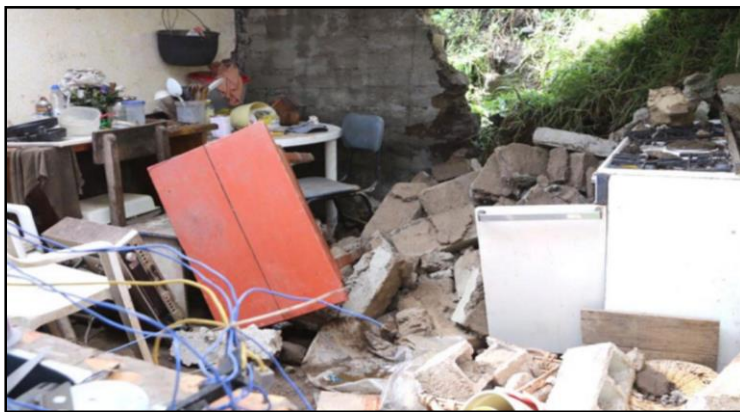
Foto No. 16 Destrucción de una vivienda del sector
