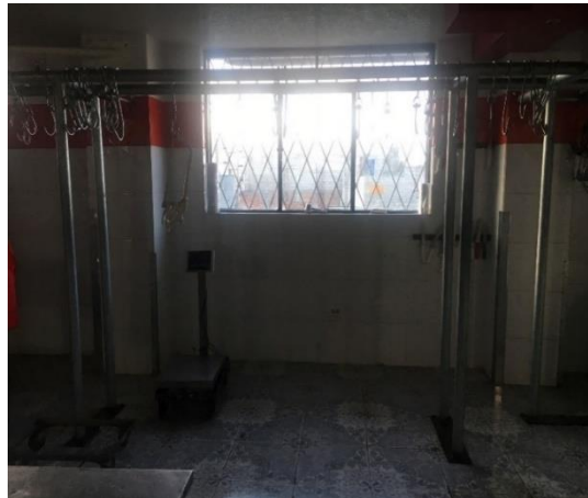
Estructura de acero inoxidable con ganchos para desposte de canales
